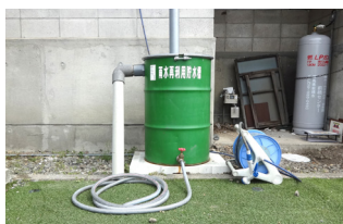
雨水をタンクに蓄え再利用
