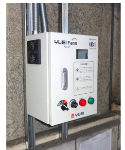
シーリングファン操作盤
