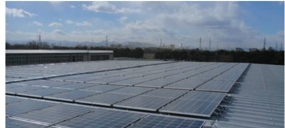
太陽光パネル
