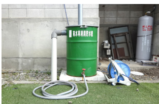
雨水をタンクに蓄え再利用
