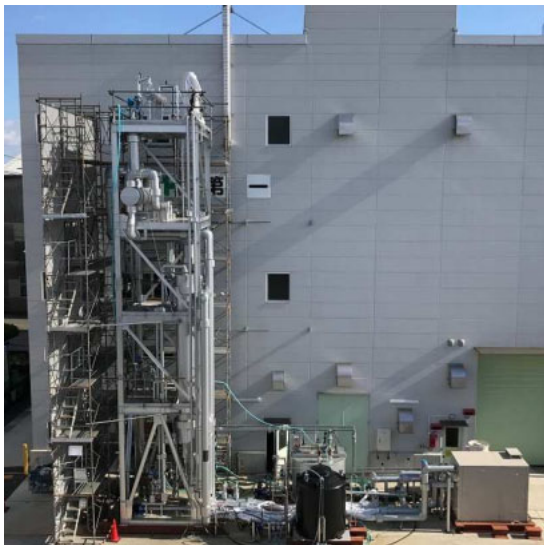
写真1 ヒートポンプ式アンモニア回収装置
