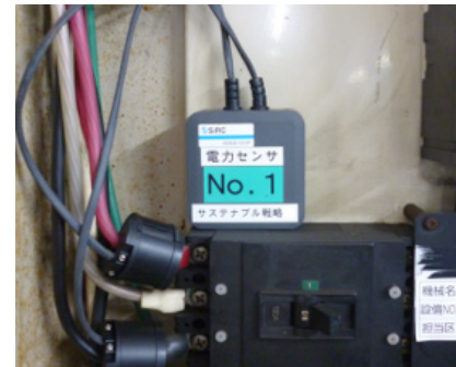
電力量の計測
