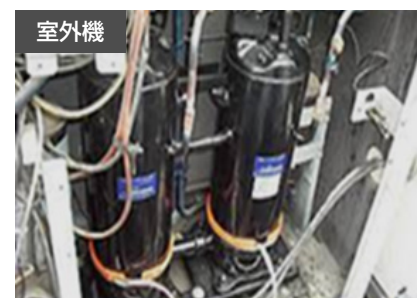
冷房専用空調機室外機の冬季電源 OFF
