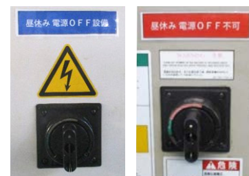
設備への昼休み電源 OFF 可能表示
