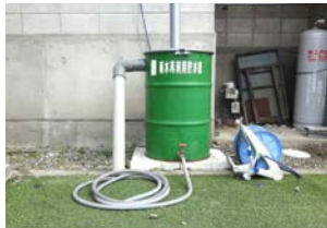
雨水をタンクに蓄え再利用
